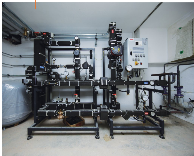
Heizzentrale mit Fernwärmeübergabestation
