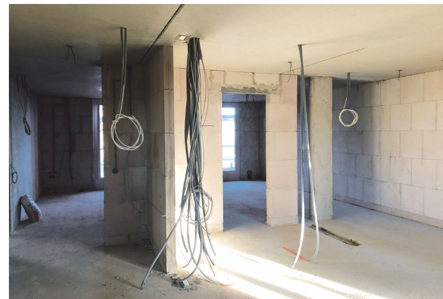
Elektro-Installation in der Wohnung
