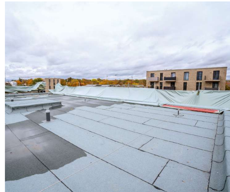
▼ Die Abdichtung auf dem Flachdach ist hergestellt. Die Dachbegrünung erfolgt im kommenden Jahr
