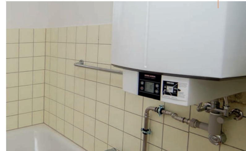
Neuer Warmwasserboiler im Badezimmer
