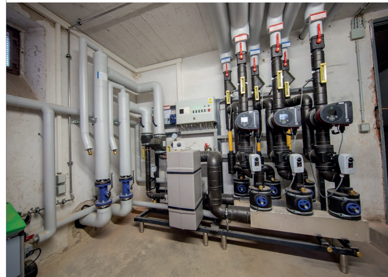
Fernwärme-Übergabestation mit Heizungsverteilung
