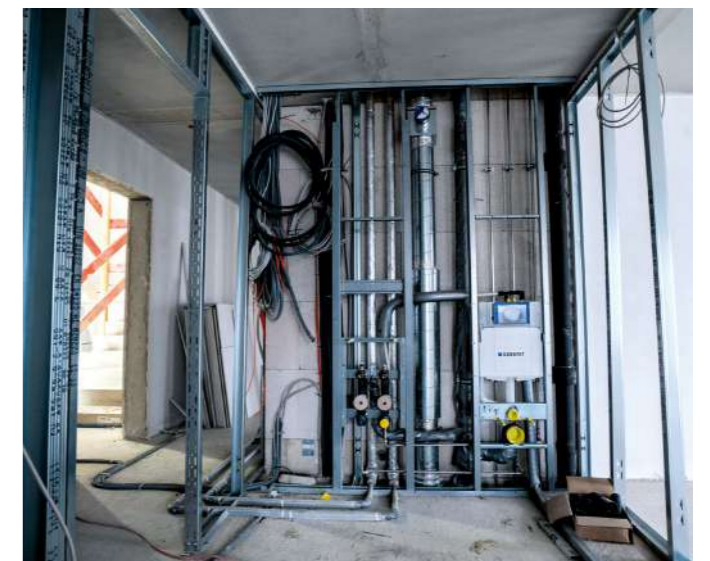
› Moderne Haustechnik sorgt künftig für einen effizienten Betrieb der Wohnungen
