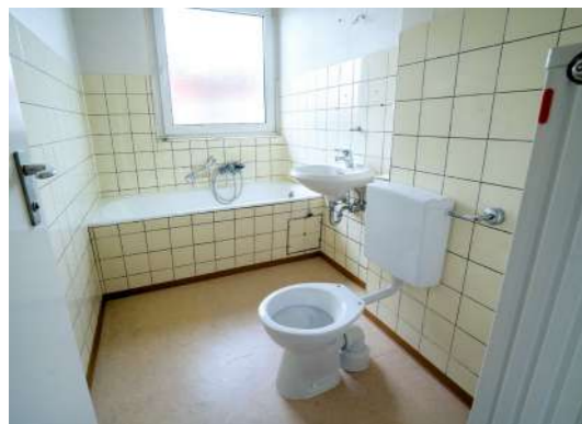
› Bauzeitliche Ausstattung der Bäder im Bestand
