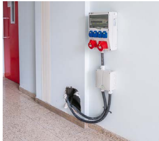
➤ Für die Modernisierungsarbeiten extra eingebaute Baustromverteilung im Flurbereich
